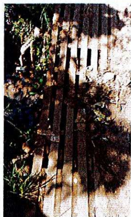
Photo 5 : Eaux usées stagnantes et déchets
